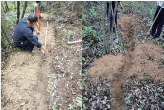
图7 现场接地网射线末端定位及长度测量
