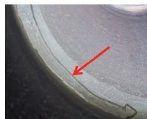
图5 内壁裂纹局部形貌
