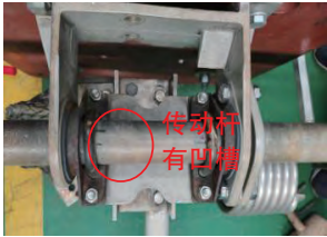
(b) 非故障相传动杆表面有凹槽
