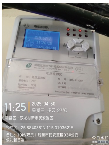
图1 实际运维中电压监测仪图片
