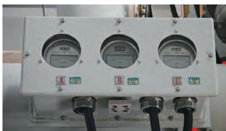
图 11 3号主变 220 kV 避雷器在线监测器修后示数
