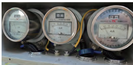
图1 3号主变220 kV避雷器在线监测器修前示数
